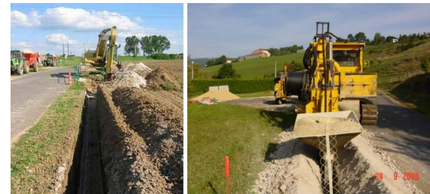
Creusement d'une tranchée pour le passage de câbles électriques HT (Source : JPEE)
